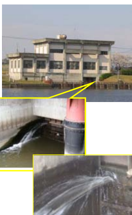
宗吾機場 ゲート漏水状況
