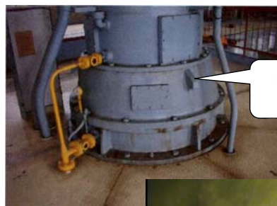
油漏れが生じている 吉高機場排水ポンプ
