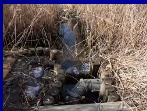
排水設備 操作3日後
