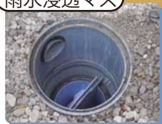
雨水浸透マス
